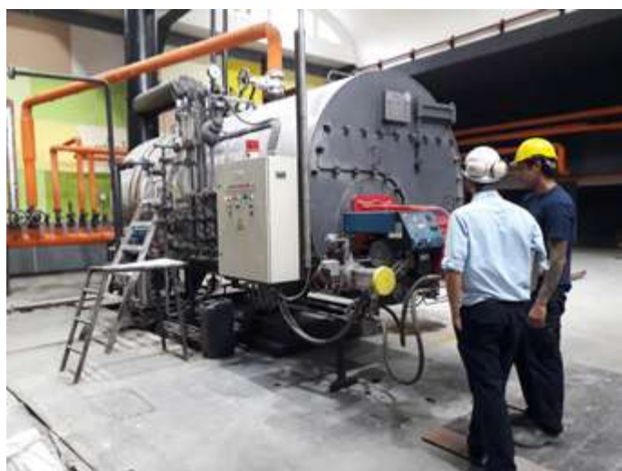
Figura 2 Prueba Anual sobre un generador de vapor
