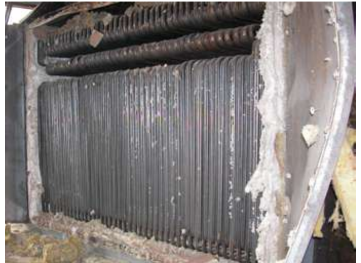
Daño a la caldera incidente, mostrando daños en el aislamiento de la carcasa y en las tuberías.
