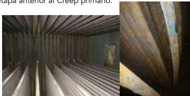
Vista interior de la caldera estudiada.
