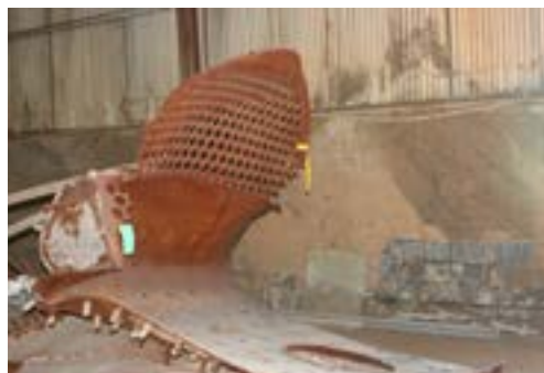
Figura #3 Parte trasera de la Caldera
