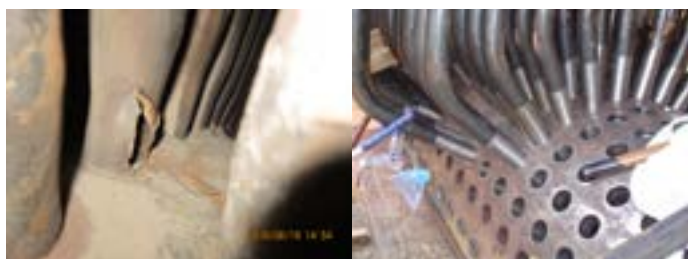
Foto # 6 Daños cubiertos por Rotura de Maquinaria
