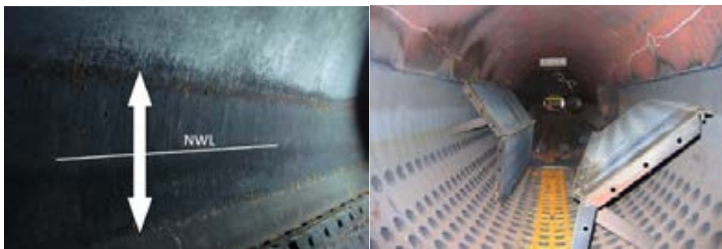
Figura 1. Problemas en nivel de agua en el domo de vapor. (a) Alta variabilidad en nivel de agua en operación. (b) Fallas en colocación de placas deflectoras (Belly Pan) causa alteraciones en el nivel de nivel a lo largo del domo.
