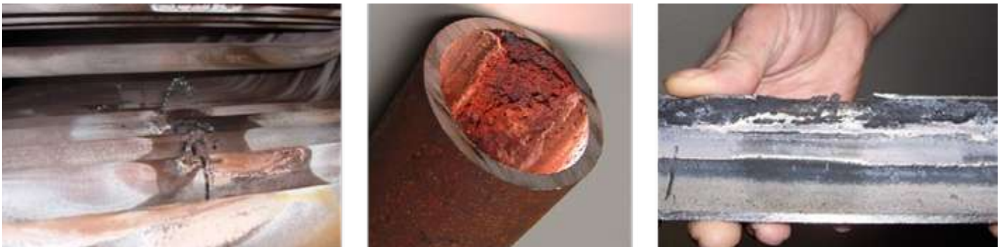
Figura # 6: Fallas de tubos en una caldera acuotubular luego de un Boil-Out en el que no se calculó adecuadamente la concentración de la solución del hervido.
