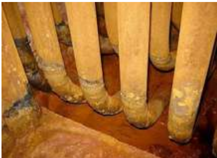
Foto #4: Parte baja de banco de tubos con agua empozada en el fondo y evidencia de sales de hierro - férrico acumulado en la superficie de los tubos humedecidos
