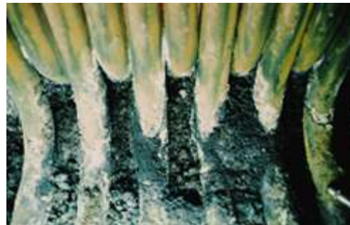
Foto #5: Acumulación de cenizas de fueloil sobre los tubos del piso del hogar de una caldera acuotubular, que contiene ácido sulfúrico y absorbe humedad atmosférica.
