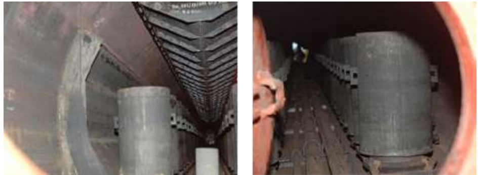
Figura # 5: Vistas del tambor superior luego de un Boil-Out exitoso
