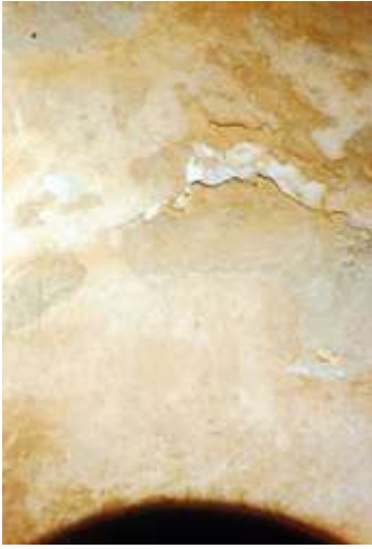
Figura #1: Vista de uno de los Caps del tambor superior. Desconchamiento de las costras de laminación, cuando alcanzan altos espesores.
