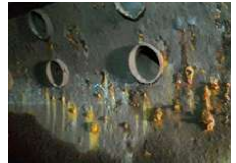
Fotos #3: Sección de tubo de agua, mostrando daños localizados en la magnetita y corrosión por picadura (Pitting)
