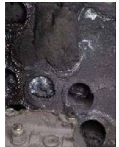
Foto #6: Acumulación de cenizas de carbón a la salida de gases luego del segundo pasó de una caldera piro-tubular, que contiene ácido clorhídrico y absorbe humedad atmosférica
